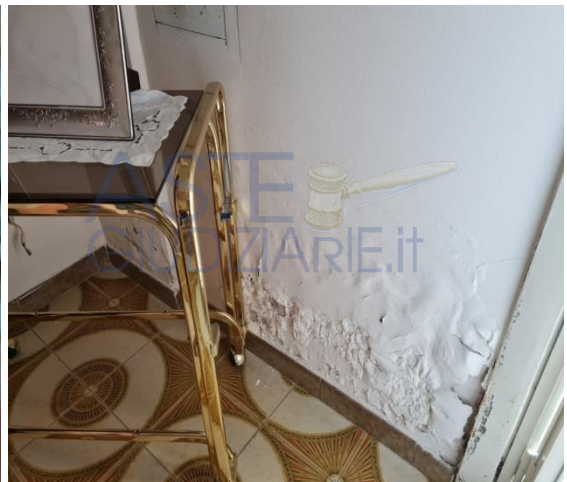
- Camera, umidità di risalita.
