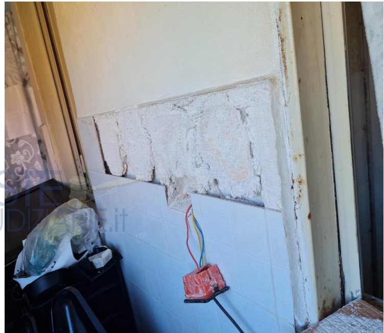
-Veranda: distacchi parietali.
