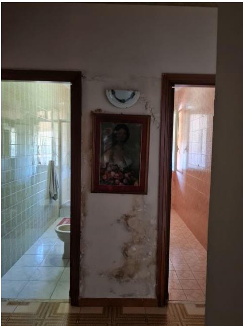
-Corridoio (danni da perdita del w.c.d.).
