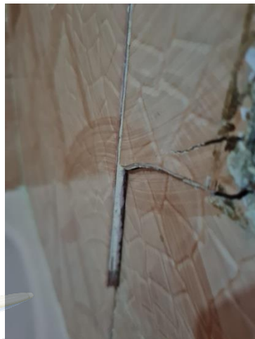
-W.c.b. distacchi parietali.
