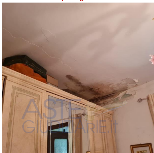
-danni da infiltrazione nel solaio.
