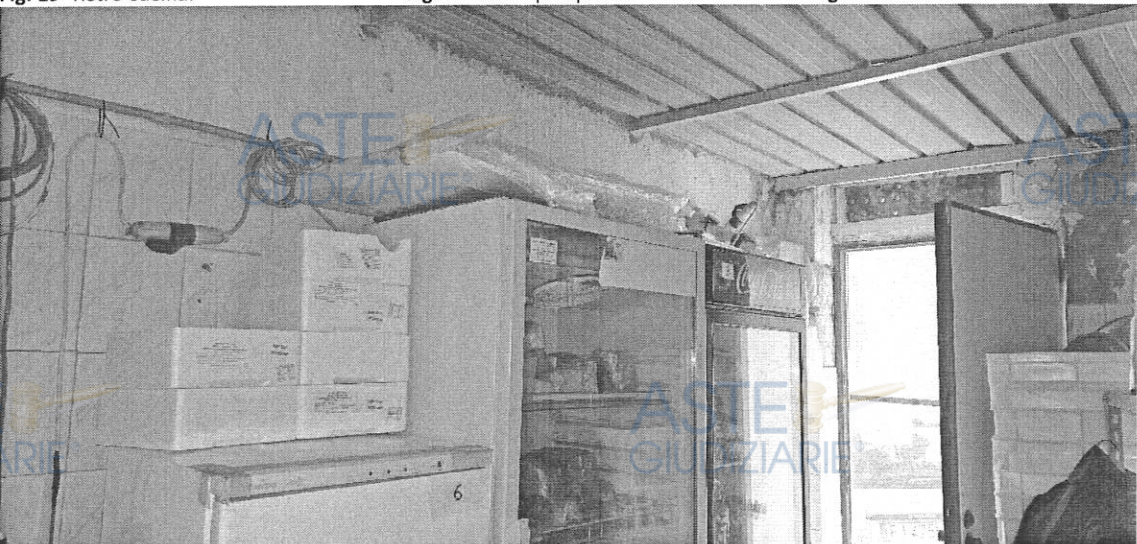
Fig. 22 - Area esterna condominiale chiusa abusivamente e da ripristinare..
