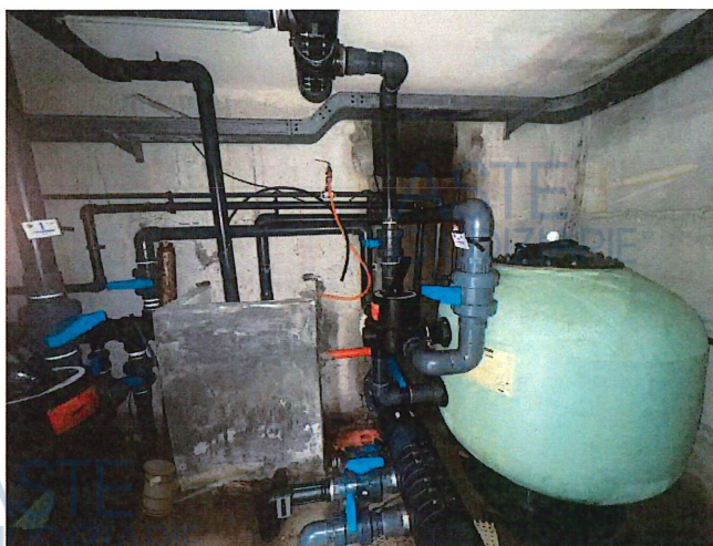
FOTO LOCALE TECNICO PISCINA
