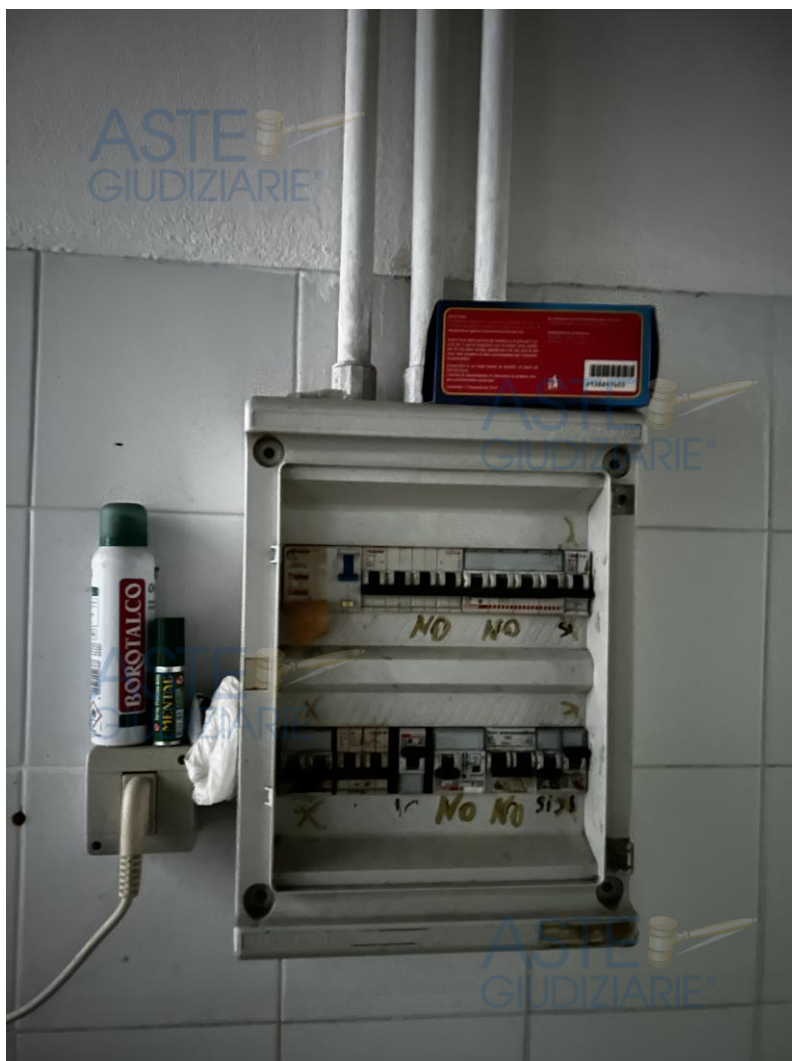
Particolare del quadro elettrico
