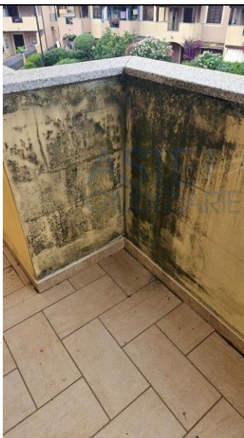
9) vista lato parapetto terrazzo da ripristinare
