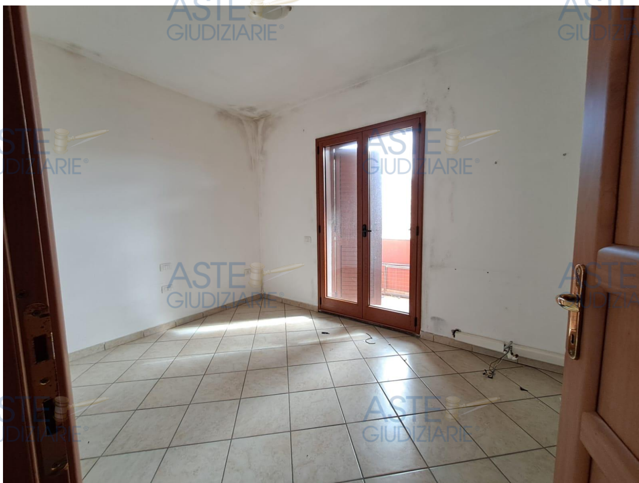
Figura 6: camera 2. Si rilevano piccole tracce di muffa. Probabilmente date dalla mancanza di manutenzione e dalla non areazione periodica dei locali
