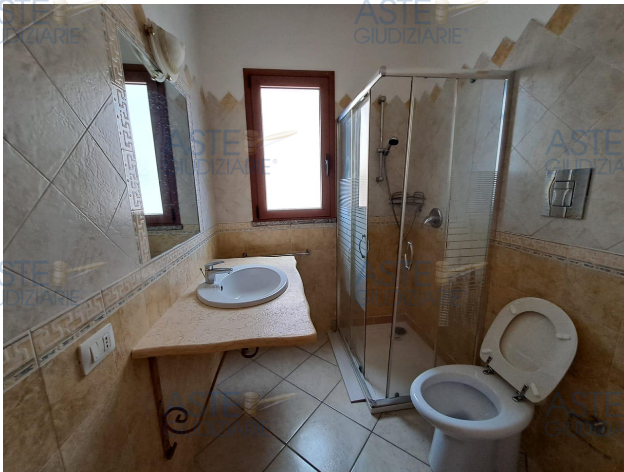
Figura 7: Bagno. La finestra in realtà dovrebbe essere chiusa con mattonvetro
