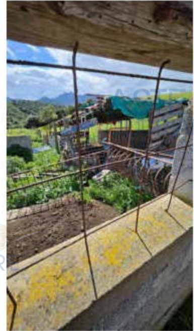
Vista struttura precaria Tettoia ( su mappale 564)
