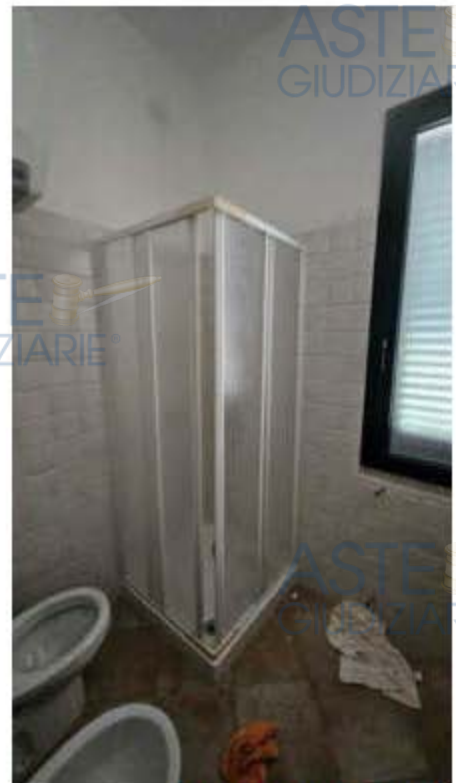
Vista ambiente bagno
