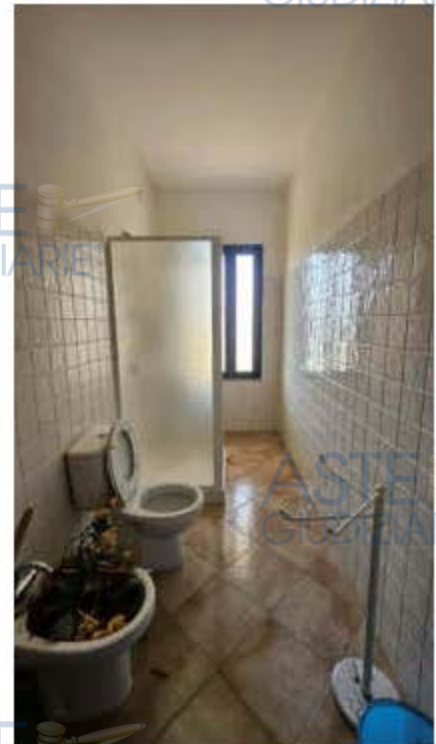
Vista ambiente bagno
