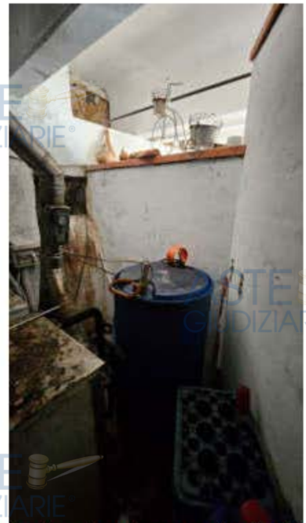
Tettoia alloggiamento impianti
