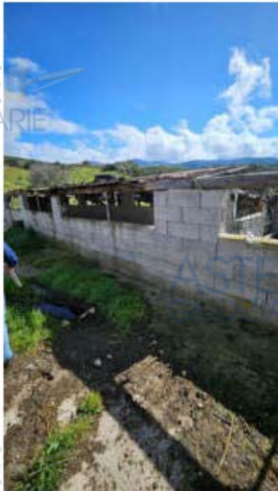
Vista struttura precaria Tettoia ( su mappale 564)
