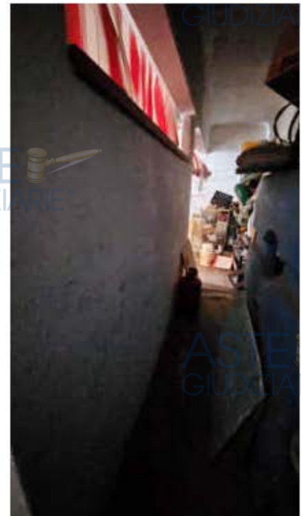
Tettoia alloggiamento impianti
