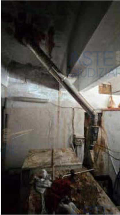
Tettoia alloggiamento impianti
