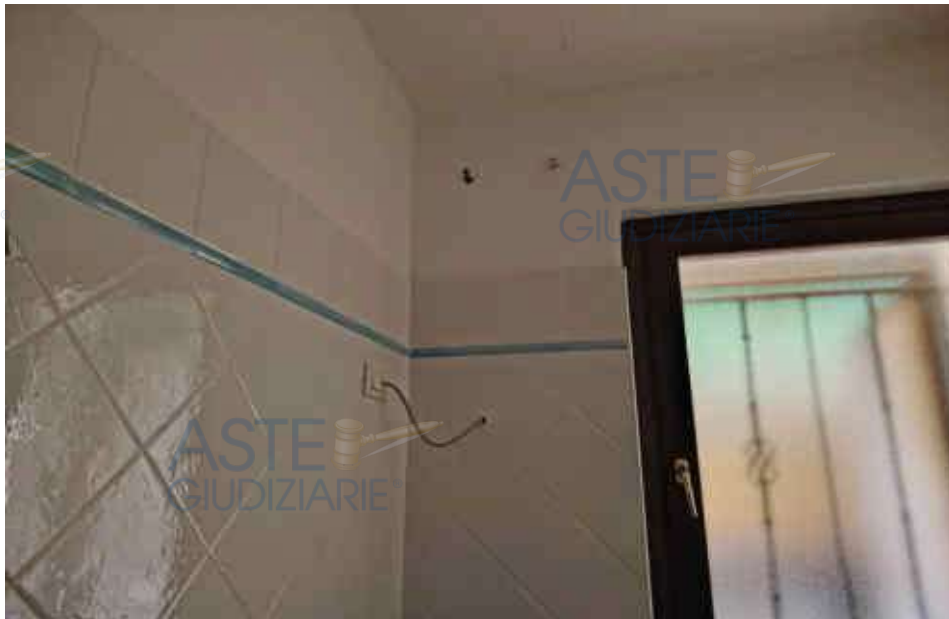
Foto 26 – Dettaglio comando accensione interno per Boiler ACS esterno
