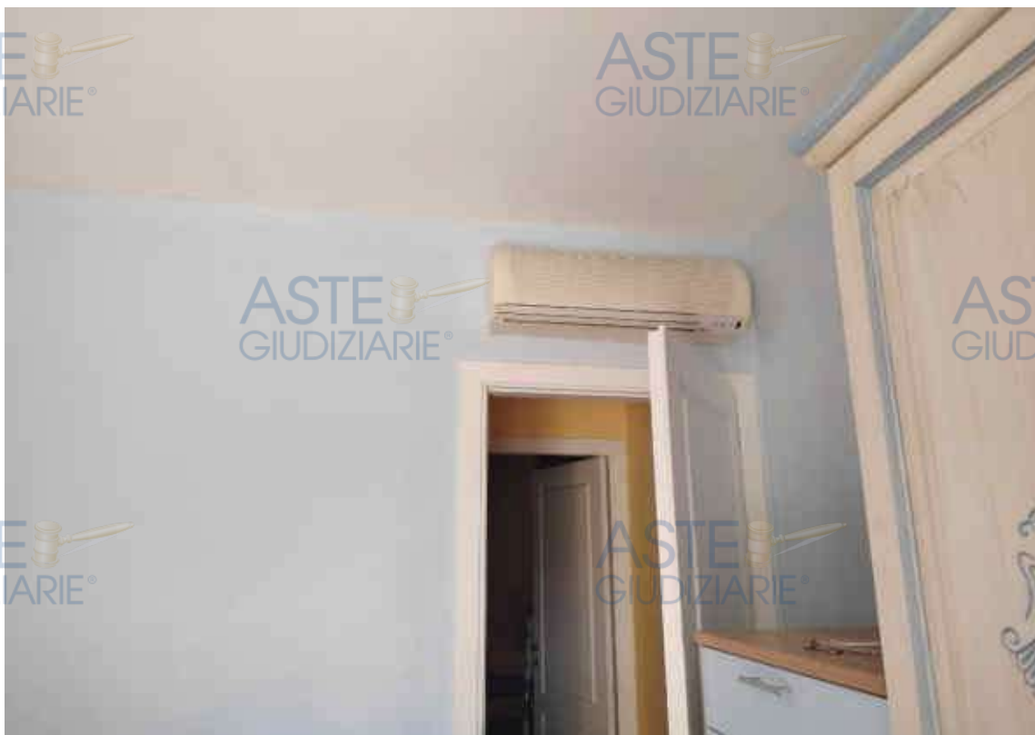
Foto 21 – Unità climatizzazione interna camera da letto principale
