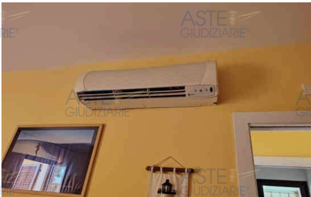
Foto 17 – Dettaglio unità interna climatizzazione soggiorno - cucina
