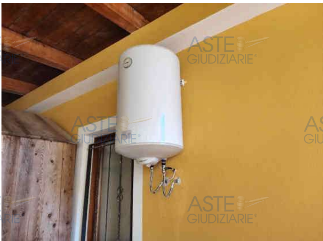
Foto 12 – Unità boiler ACS sotto veranda coperta
