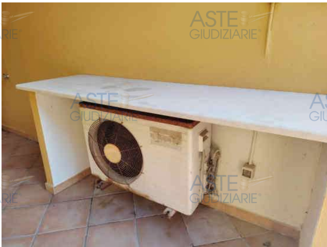
Foto 11 – Unità climatizzatore sotto veranda coperta
