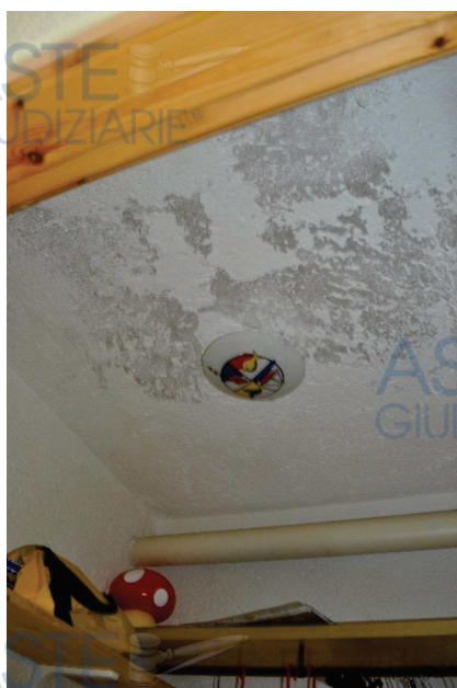
Figg.26-27. Dettaglio dell'umidità sul solaio
