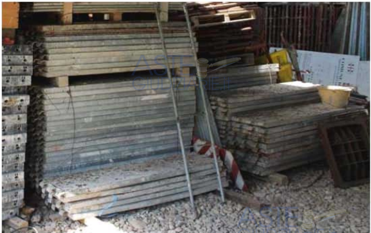
Foto 57 - Piani di calpestio per ponteggio; zincati; circa 84 pezzi di difficile conteggio; marcature non leggibili; stato di corrosione ignoto; non conformi a D. lgs. 81-2008.
