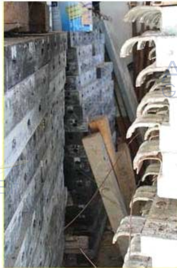
Foto 89 – Blocco di pannelli retrostante.
