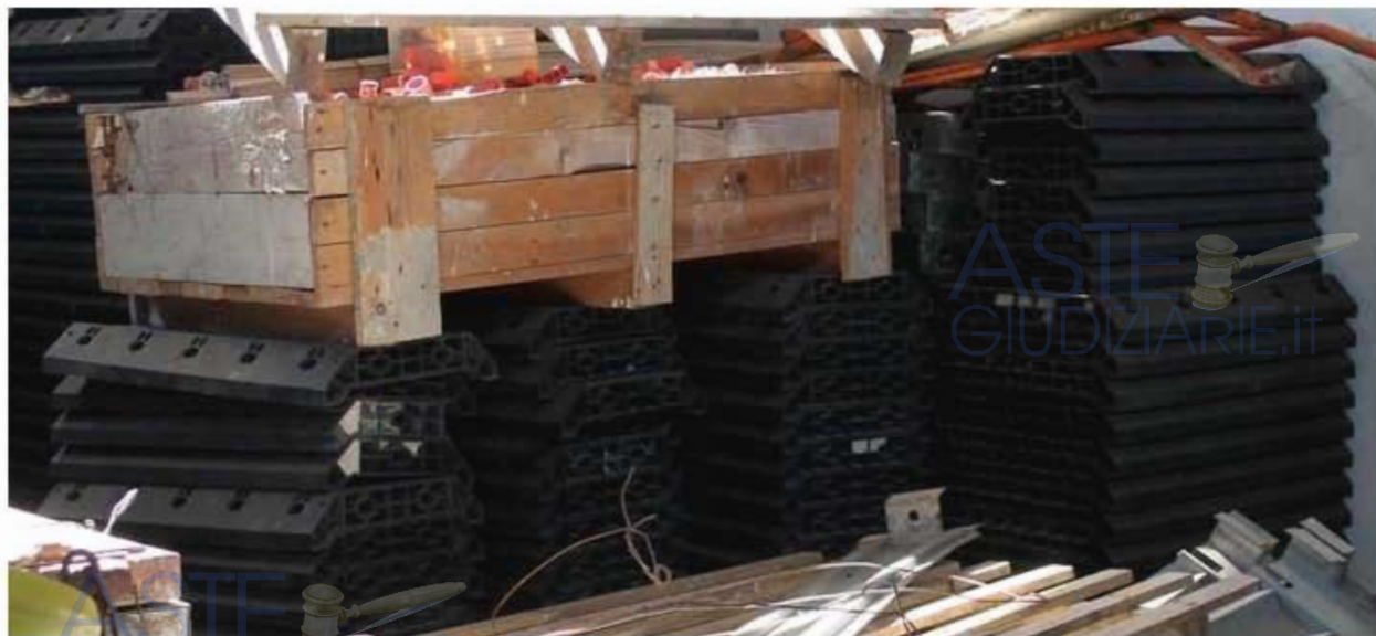
Foto 70 – Casseri in PVC con accessori di montaggio, di difficile conteggio a causa della posizione.
