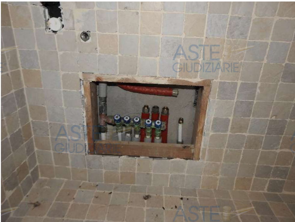
Figura 55 – Collettore impianto idrico piano seminterrato
