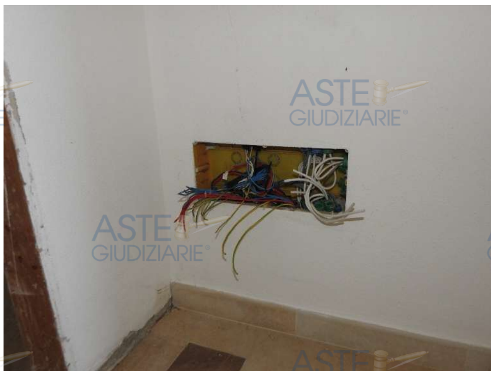
Figura 57 - Scatola di derivazione impianto elettrico, collegamenti mancanti
