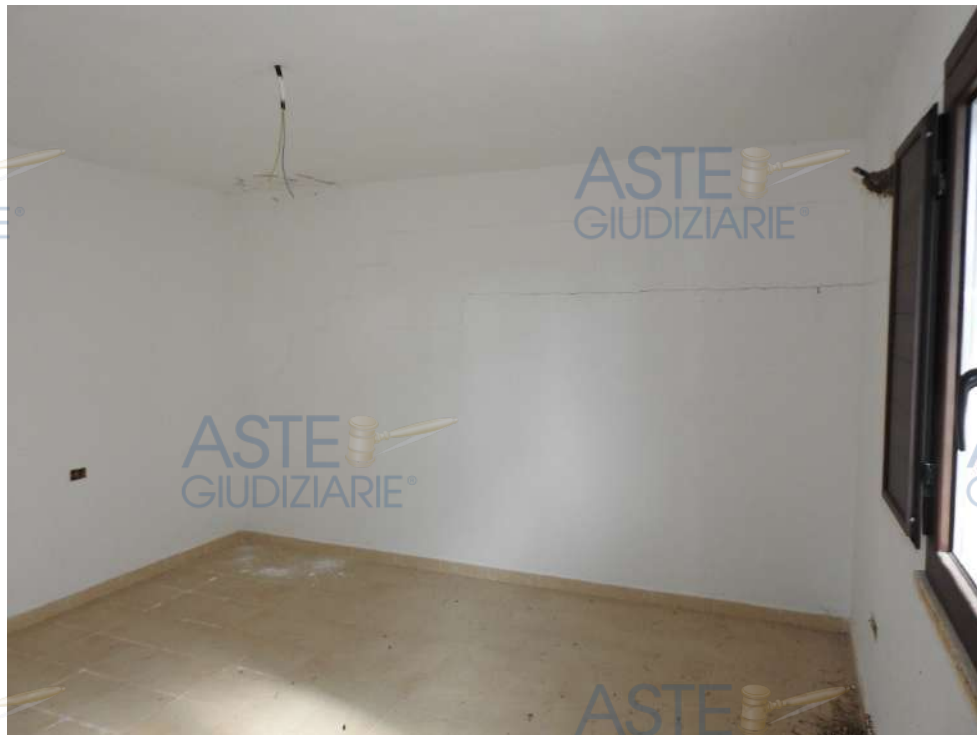
Figura 29 - Piano seminterrato, cantina. Si notino le infiltrazioni dalla parete controterra e le fessurazioni.
