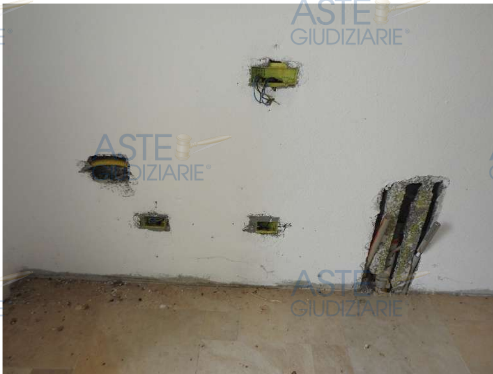
Figura 56 – Impianti non ultimati (cucina)
