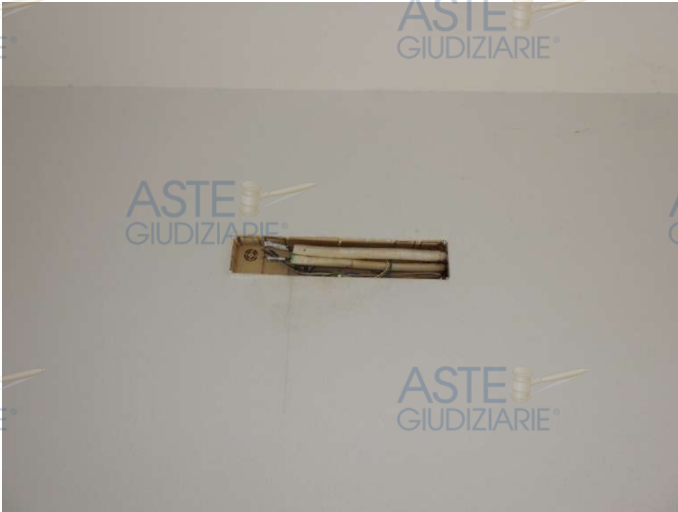
Figura 58 - Impianto di climatizzazione, predisposizione.
