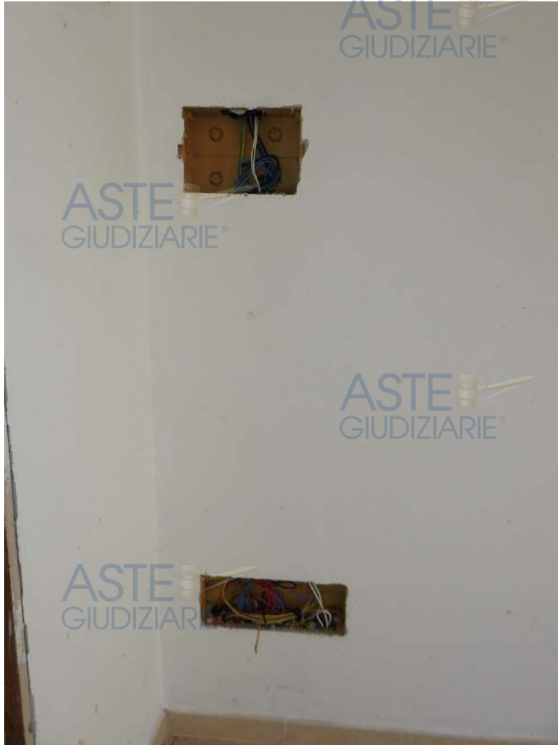
Figura 50 - Piano seminterrato e impianti non ultimati
