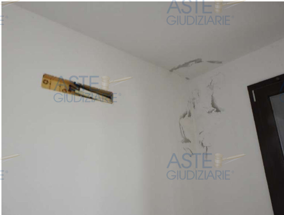
Figura 54 - Impianto di climatizzazione, predisposizione. Infiltrazioni da acque meteoriche.
