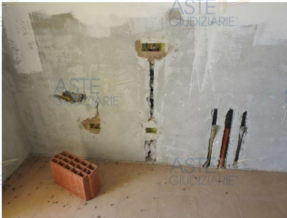
Figura 52 – Impianti non ultimati (cucina)
