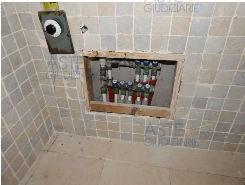
Figura 51 - Collettore impianto idrico piano seminterrato
