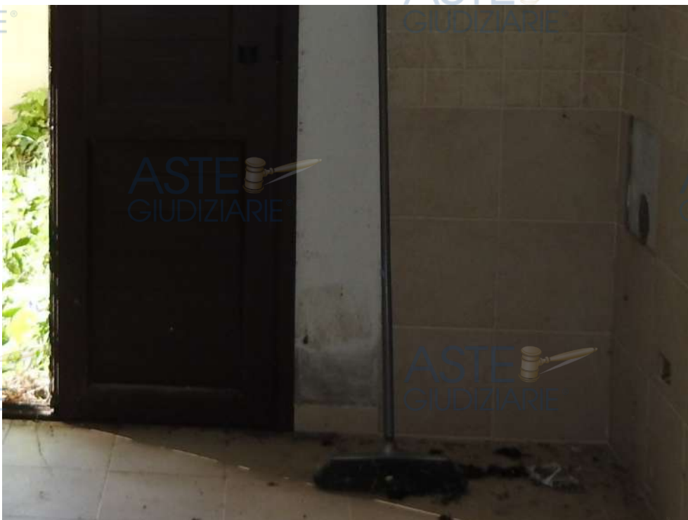
Figura 49 - Patologie edilizie, umidità per capillarità al piano seminterrato
