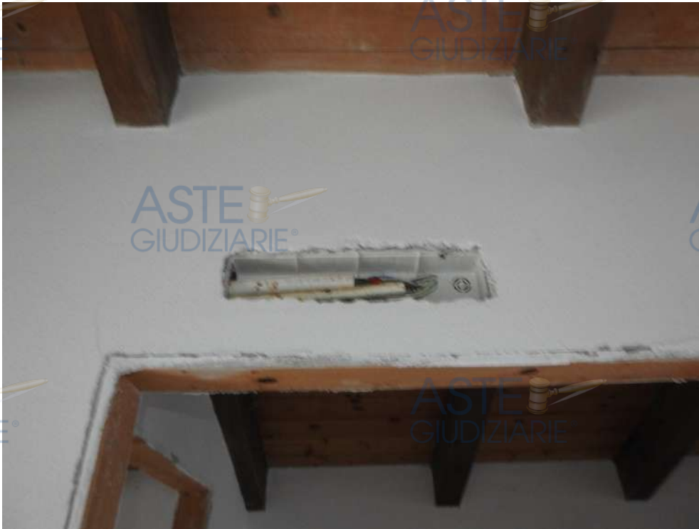
Figura 56 - Impianto di climatizzazione, predisposizione.
