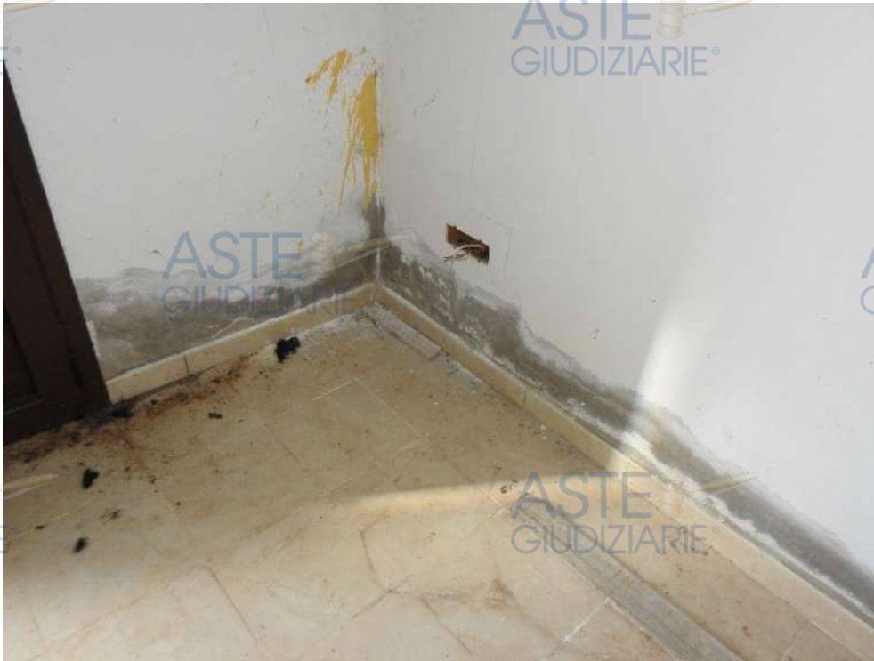
Figura 50 - Patologie edilizie, umidità per capillarità al piano seminterrato
