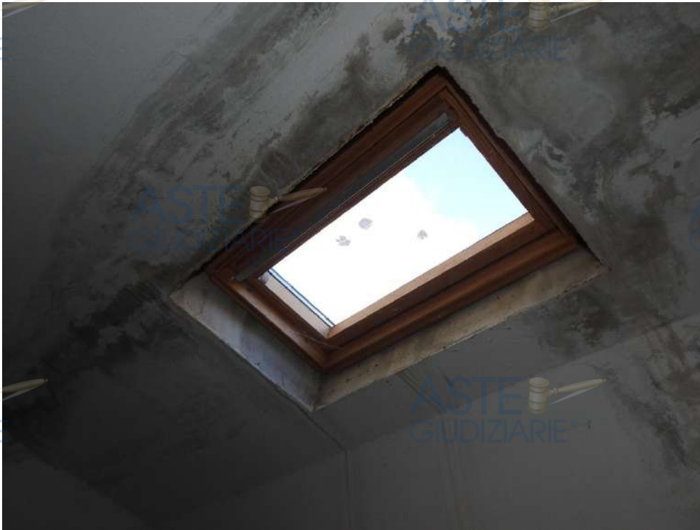
Figura 52 - Patologie edilizie, importanti infiltrazioni nella zona del lucernario (piano terra)
