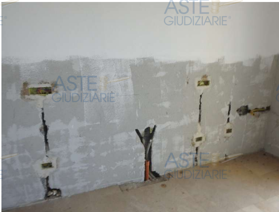
Figura 54 – Impianti non ultimati (cucina)
