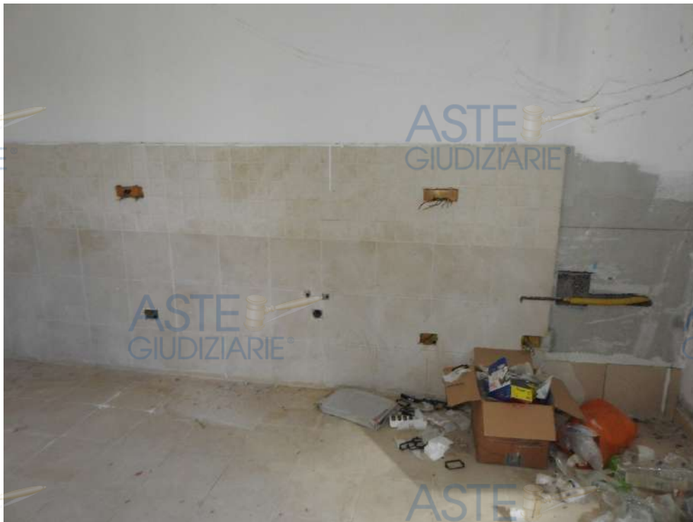
Figura 51 - Piano seminterrato e impianti non ultimati
