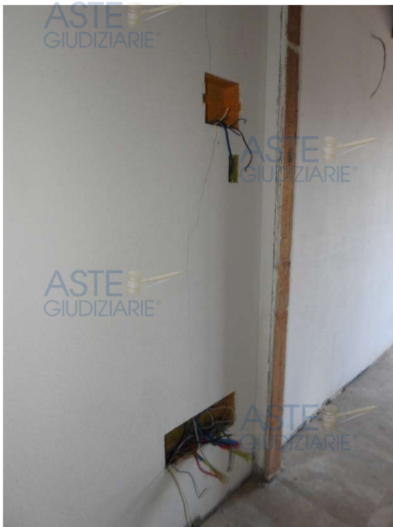
Figura 55 - Scatola di derivazione impianto elettrico, collegamenti mancanti
