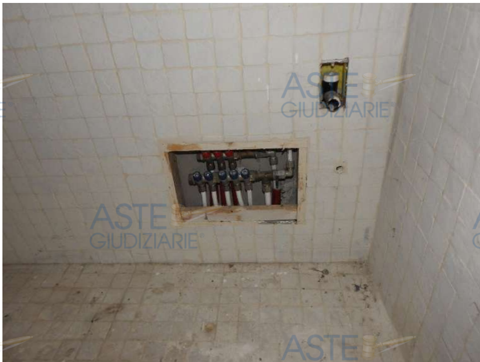
Figura 53 – Collettore impianto idrico piano seminterrato
