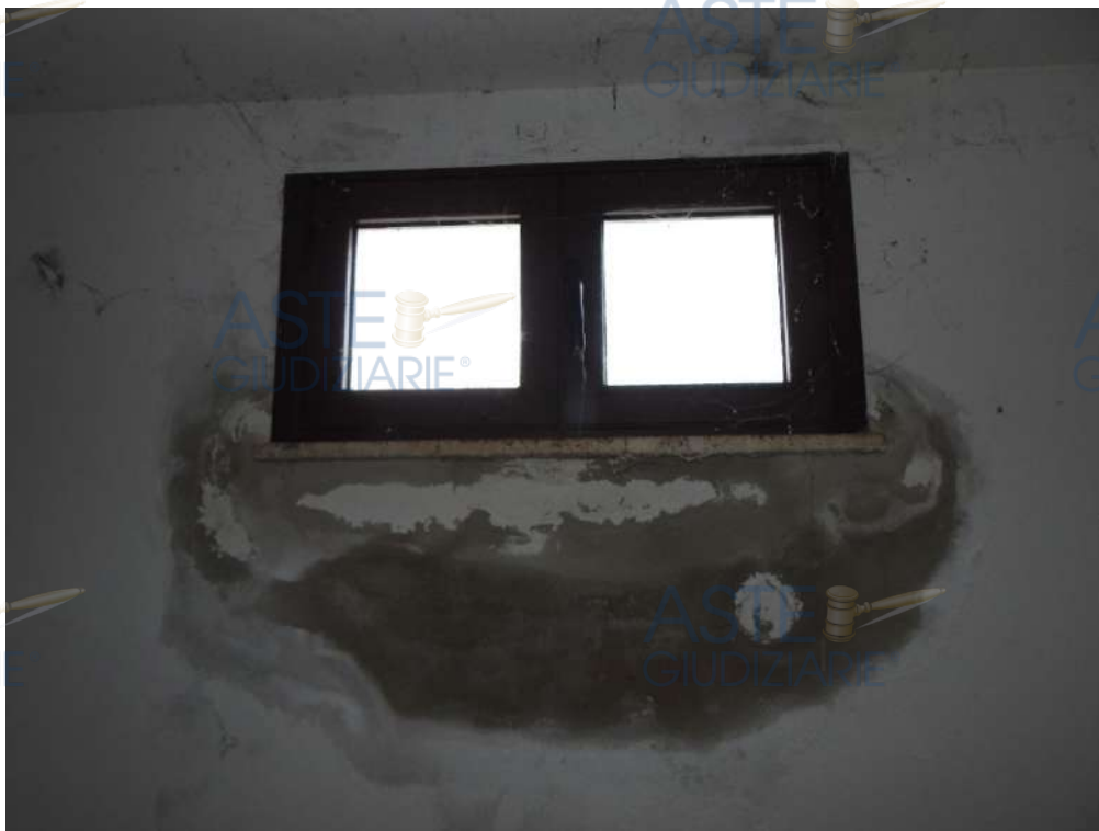
Figura 52 - Patologie edilizie, infiltrazioni in corrispondenza del serramento
