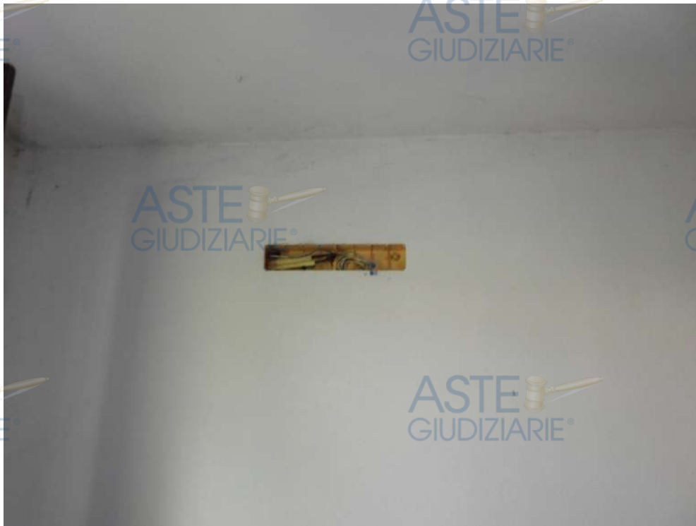
Figura 56 - Impianto di climatizzazione, predisposizione.
