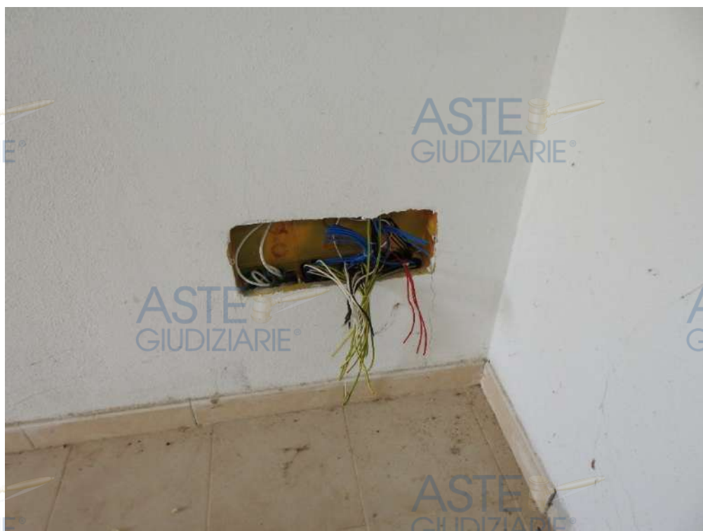
Figura 53 - Scatola di derivazione impianto elettrico, collegamenti mancanti
