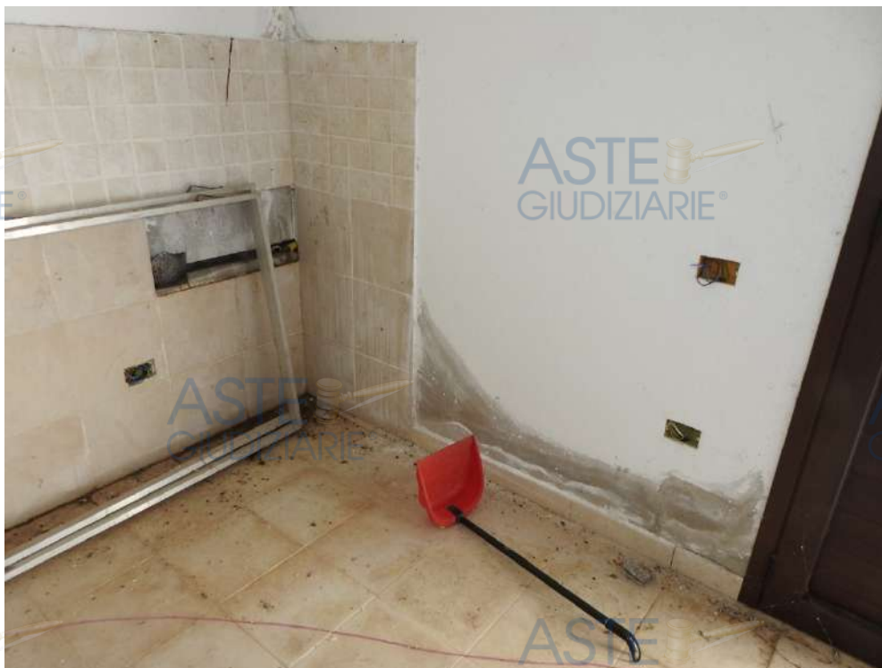
Figura 51 - Patologie edilizie, umidità per capillarità al piano seminterrato
