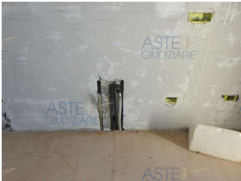
Figura 55 – Impianti non ultimati (cucina)
