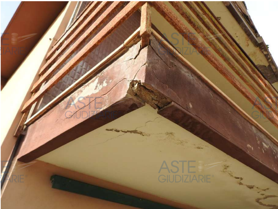
Figura 50 - Immobile 2 (negoziò), degrado calcestruzzo balconata
