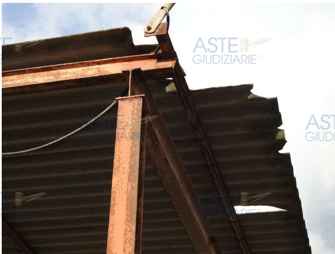
Figura 83 - Immobile 5 (tettoia operativa). Degrado copertura in cemento amianto.
