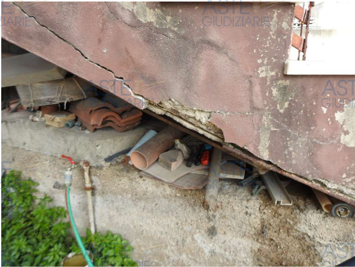
Figura 49 - Immobile 2 (negoziò), degrado calcestruzzo scalinata di accesso
