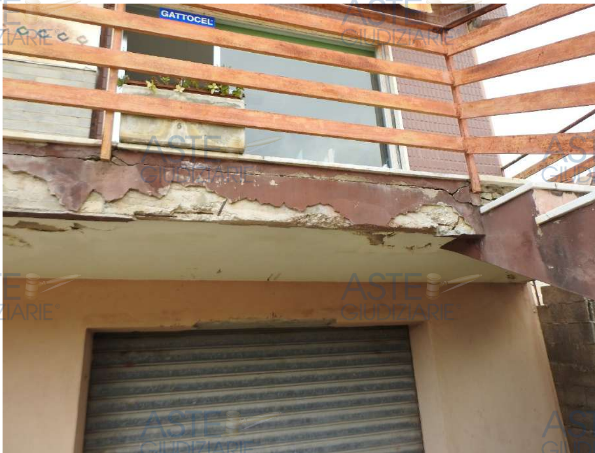
Figura 51 - Immobile 2 (negozio), degrado calcestruzzo balconata
