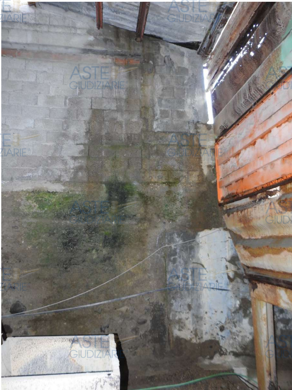
Figura 72 - Immobile 4 (capannone principale), blocco 4A. Zona retro, degrado parete controterra.
