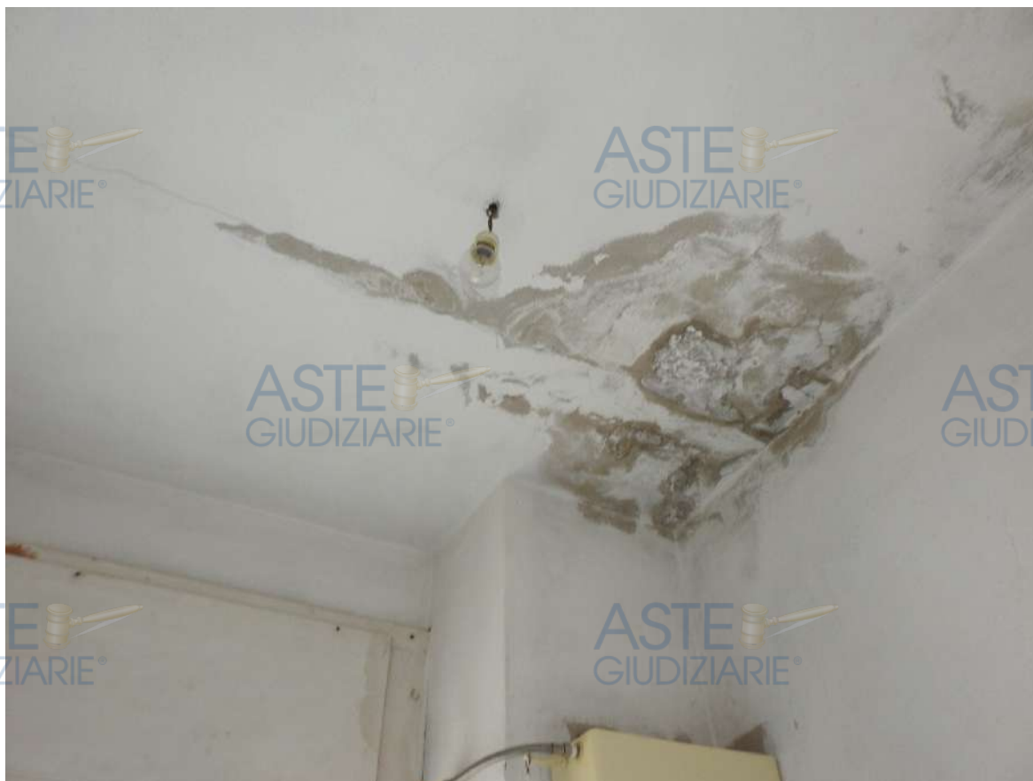
Figura 48 - Immobile 2 (negozio), infiltrazioni bagno
