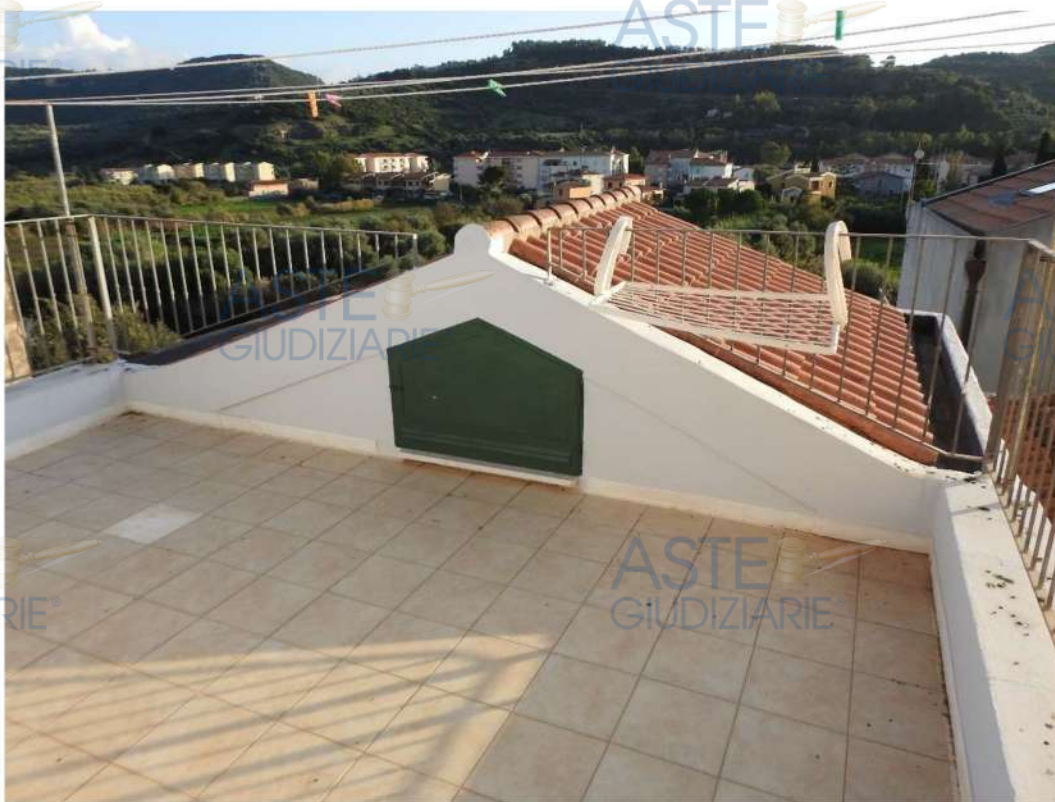
Figura 20 - Terrazza condominiale (abusiva). Visuale dalla porta finestra
