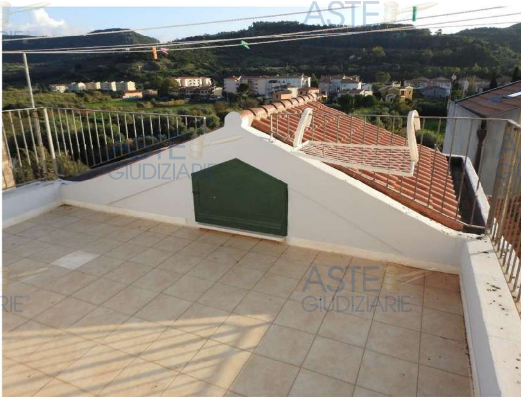
Figura 20 - Terrazza condominiale (abusiva). Visuale dalla porta finestra
