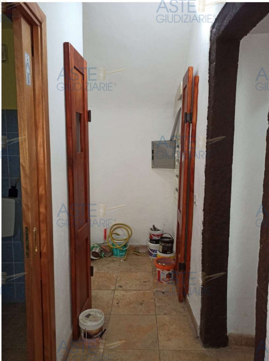
Figura 38 - Disimpegno di ingresso dall'androne comune, visuale verso il corridoio che porta alla cucina. A sinistra si intravede il wc donne/disabili e a destra il varco di comunicazione con le sale ristorazione. In fondo a destra è ubicato il quadro elettrico.
