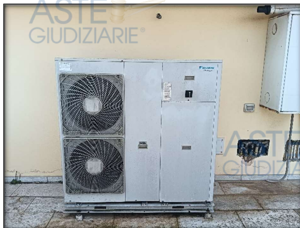
Foto 12 – Particolare chiller climatizzazione
