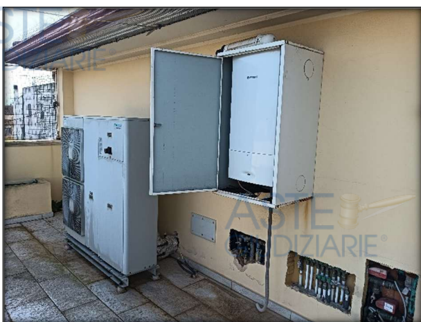
Foto 13 – Particolare chiller e scaldacqua a gas
