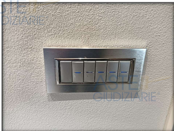
Foto 27 – Gestione impianto di illuminazione interna
