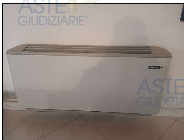
Foto 30 – Unità interna di climatizzazione
