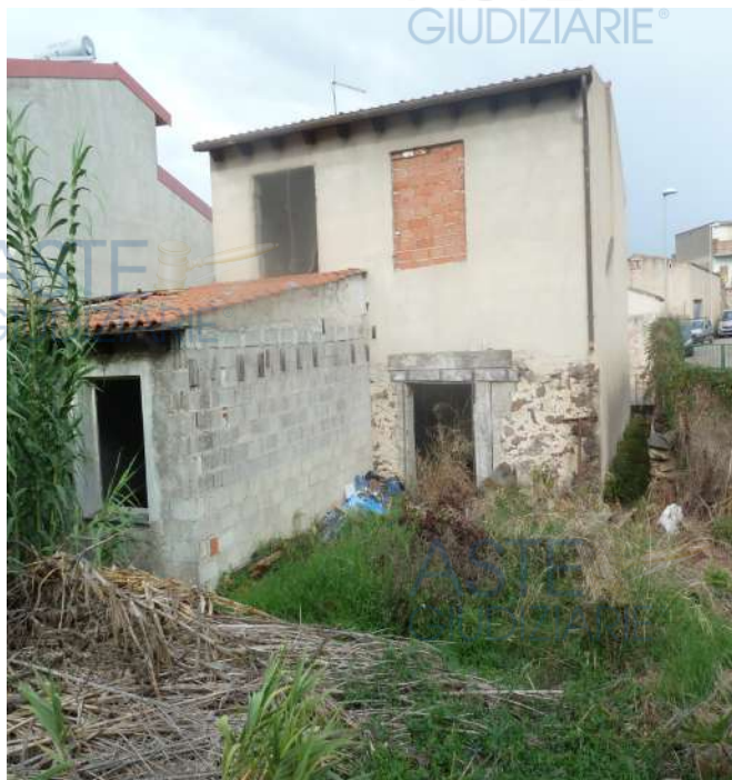
Foto prospetto posteriore con vano abusivo
