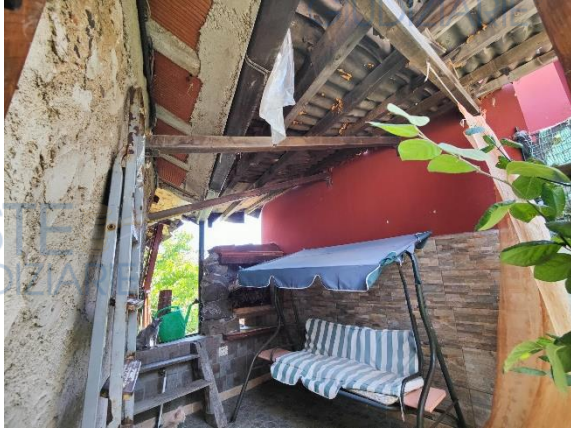
COPERTURA POSTICCIA VERANDA P. 1 POSTERIORE DA RIMUOVERE (abusiva)
