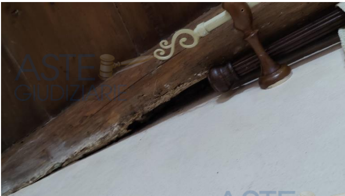
TRAVE SOLAIO SALOTTO (marcescenza da infiltrazione)
