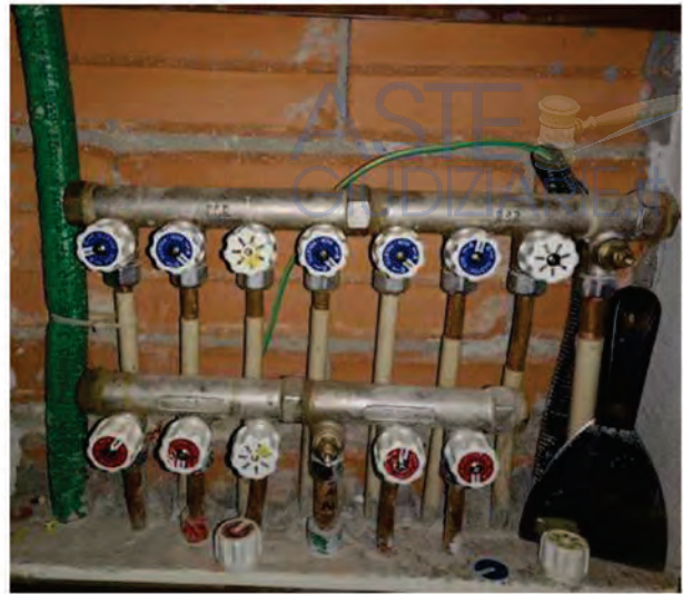
Immagine 15: Collettore di distribuzione dell'acqua sanitaria
