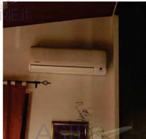
Immagine 13: Pompa di calore, unità interna
