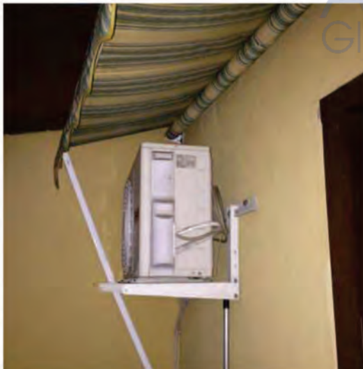
Immagine 12: Pompa di calore, unità esterna
