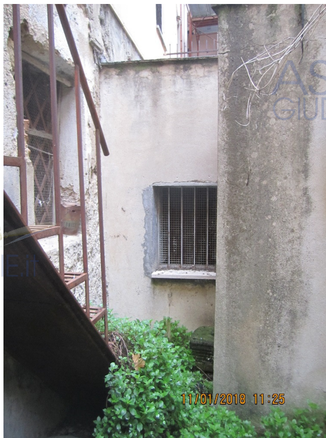
Foto 3: servizio igienico in abuso
