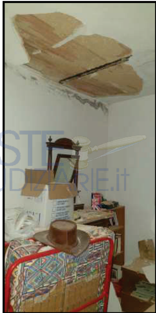
LO SFONDELLAMENTO DEL SOLAIO
