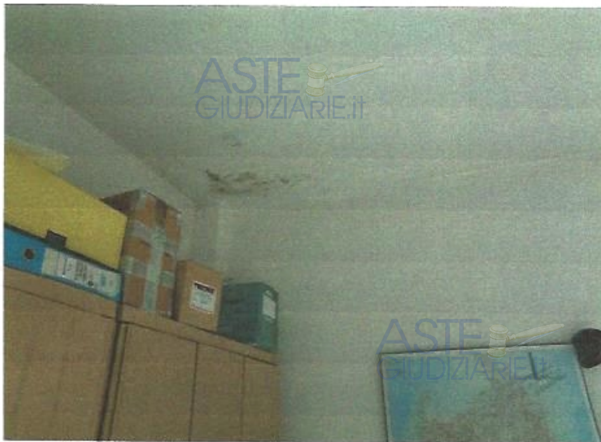
Interni al Piano Primo - tracce di infiltrazioni d'acqua dal solaio di copertura
