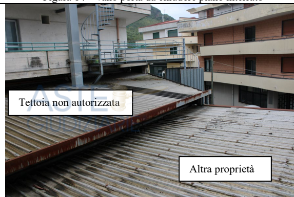
Figura 16 – tettoia e scala in ferro non autorizzate
