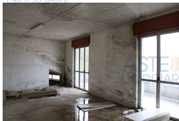
Figura 8- Danni da infiltrazioni
