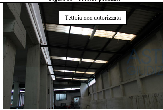
Figura 12 – tettoia non autorizzata piano terra
