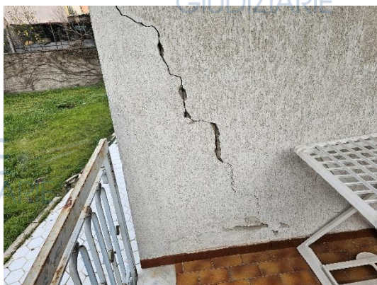
Presenza crepe pareti esterne
