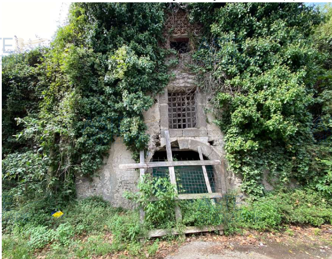
FOTO N.4 Fabbricato diruto e terreno limitrofo - Via Nufilo N.1 - Baronissi (Sa)
