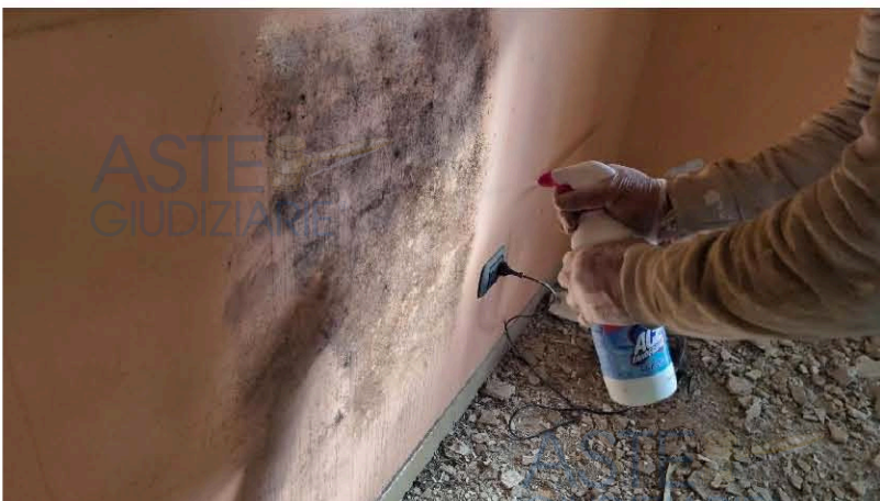
Foto n.3: trattamento antimuffa pareti camera da letto
