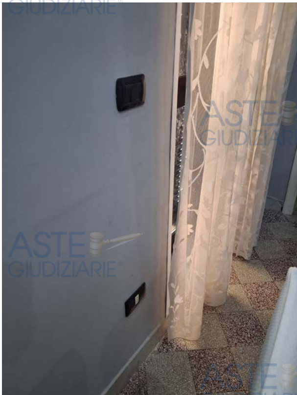
Foto 23 – Particolare impianto elettrico
