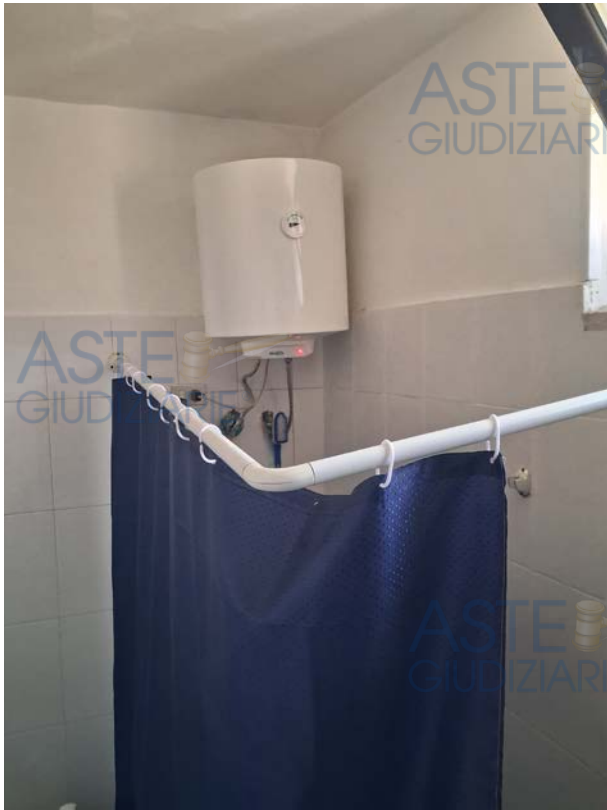
Foto 21 – Boiler bagno P1
