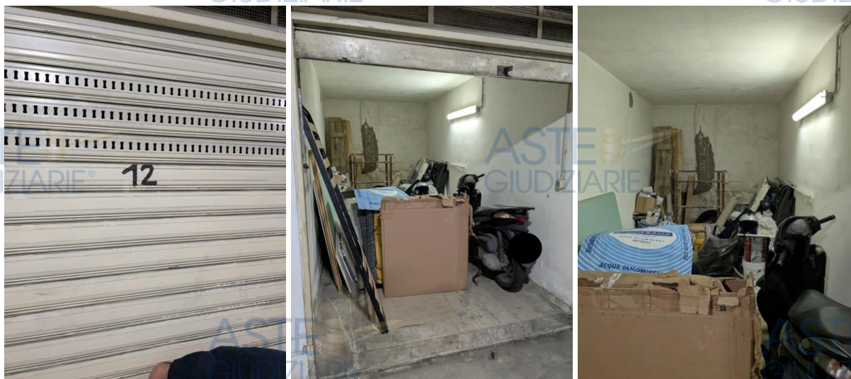
Viste di dettaglio di serranda con numero di interno e fenomeni di degrado che riguardano il box auto sub. 138.
