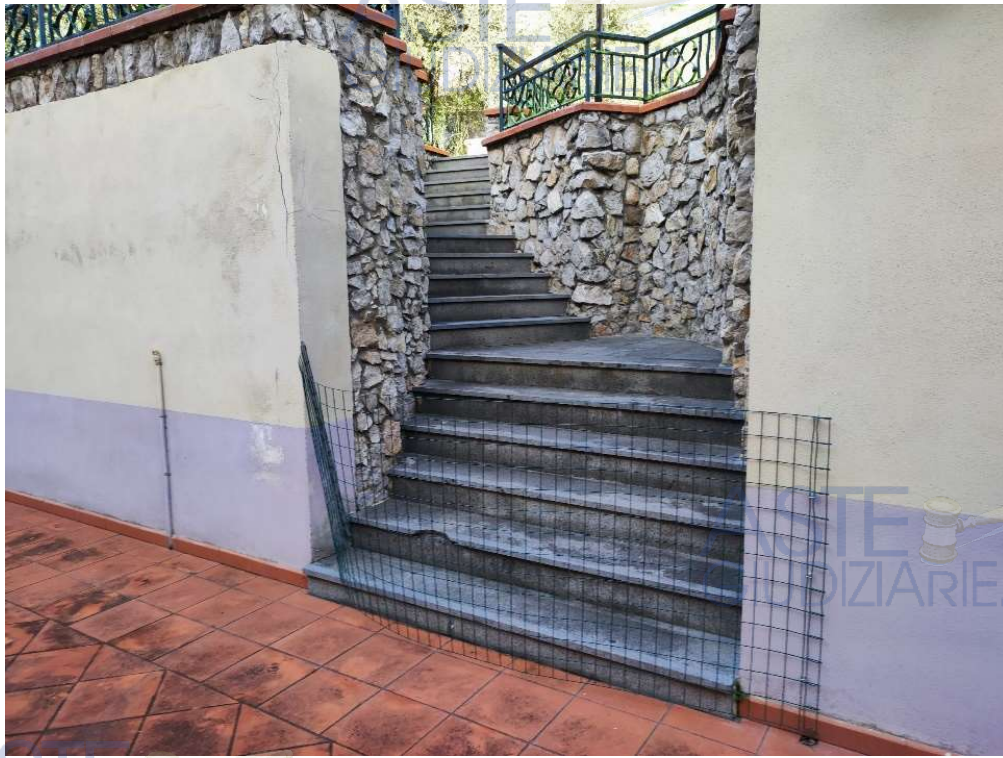
Fig. 184: terreno pignorato P.lla 688, scale accesso a p.lla 54 edif. pignor. (lotti 1-5) (da oper. perit.)
