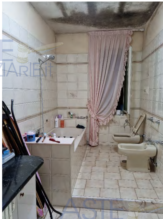
Bagno 2 - particolare di fenomeno condensativo
