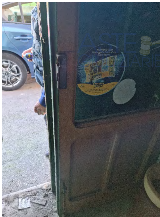
Infisso in pessimo stato manutentivo
