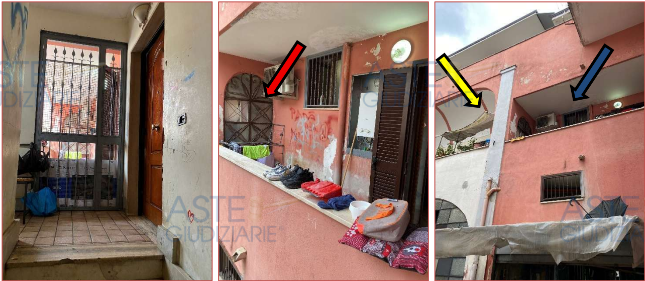
FIGURA 2. A SINISTRA: CANCELLO TRA IL PIANEROTTOLO E IL BALCONE (ORIGINARIO BALLATOIO). AL CENTRO: BALCONE (ORIGINARIO BALLATOIO) CON CANCELLO DI ACCESSO AD ALTRO IMMOBILE (INDICATO CON LA FRECCIA ROSSA). A DESTRA: BALCONE (ORIGINARIO BALLATOIO, INDICATO CON FRECCIA BLU) E IMMOBILE CONFINANTE (INDICATO CON FRECCIA GIALLA).
