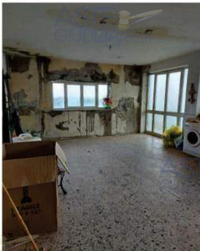
Foto - IMMOBILE 3 Terrazzo coperto lato SUD particolare intonaco deteriorato
