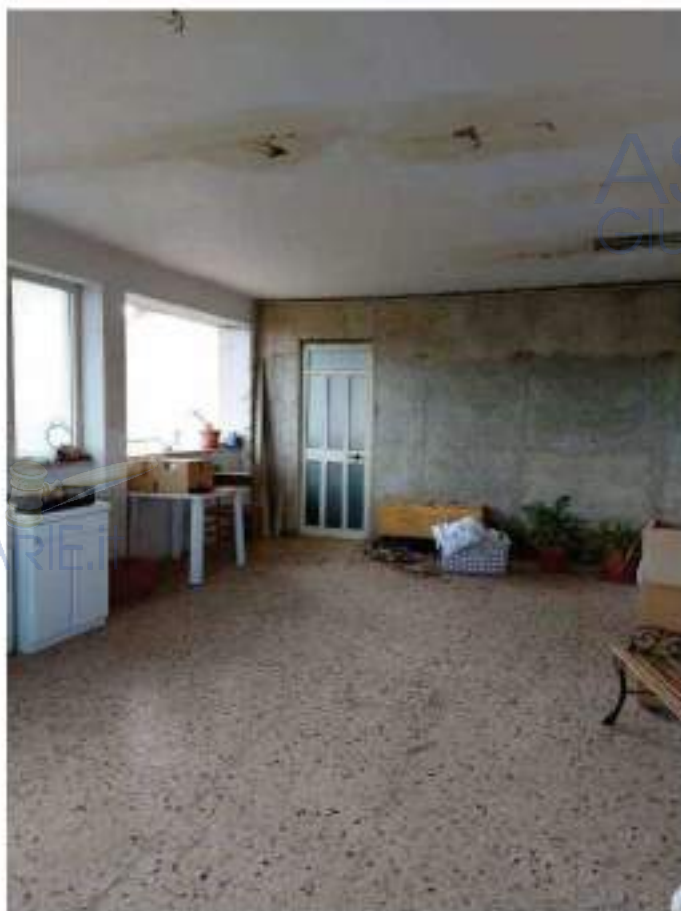
Foto - IMMOBILE 3 Terrazzo coperto lato SUD particolare infiltrazione
