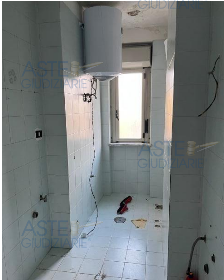
W.C. PRIVO DI SANITARI
