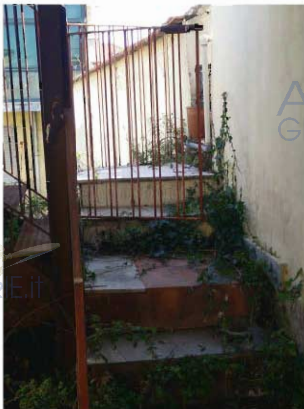
Foto n. 28 – Accesso ad altra proprietà dalla scala in ferro
