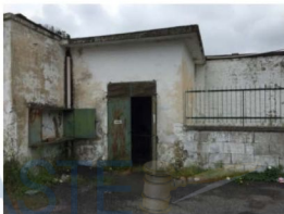
Immobile 04 cabina elettrica
