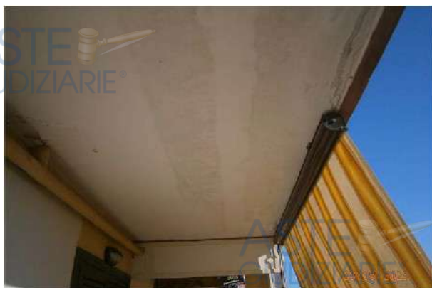
Foto n° 33 Particolare Soffitto Lato Ovest
