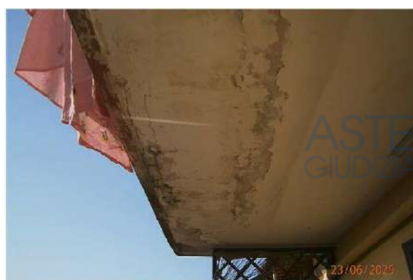
Foto n° 30 Particolare Soffitto Lato Ovest
