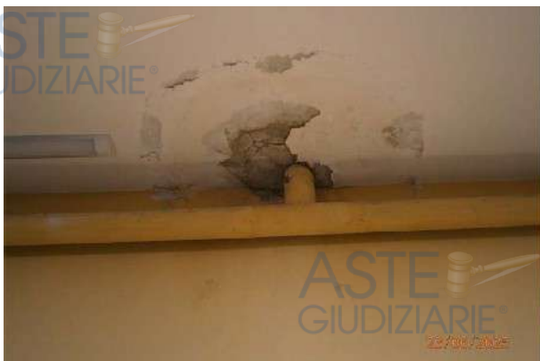
Foto n° 31 Particolare Soffitto Lato Ovest
