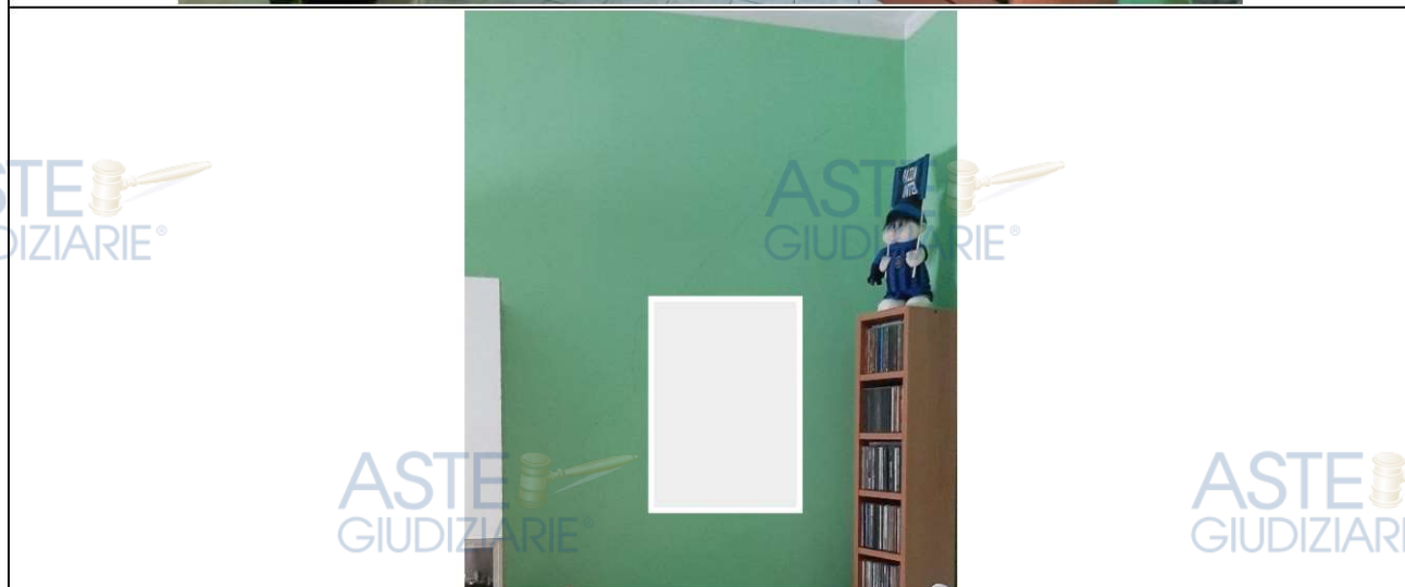
Foto 9/10 – vista camera 2 e particolare della lieve lesione di intonaco
