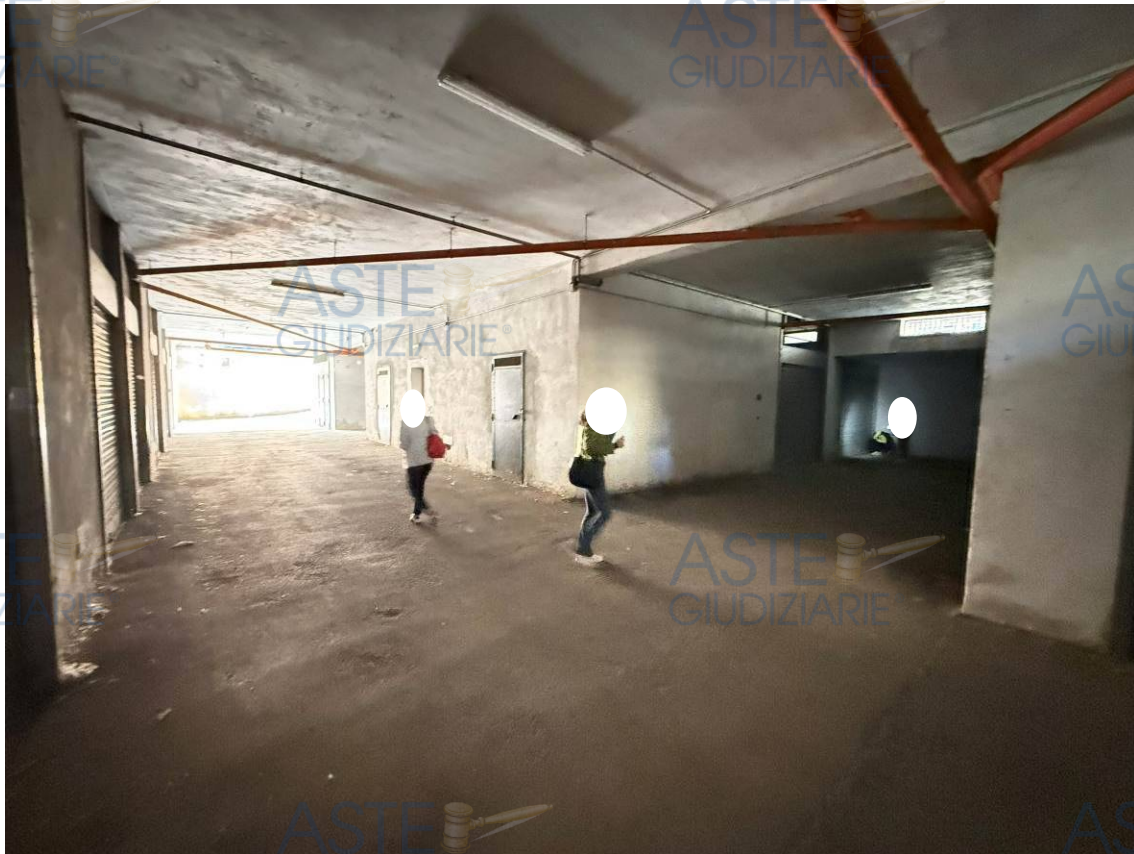
Foto 27 - Area comune di manovra sub 11
