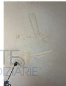
Foto n. 28 - Cucina - particolare delle macchie a soffitto
