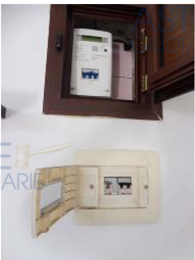
_contatore e quadro elettrico
