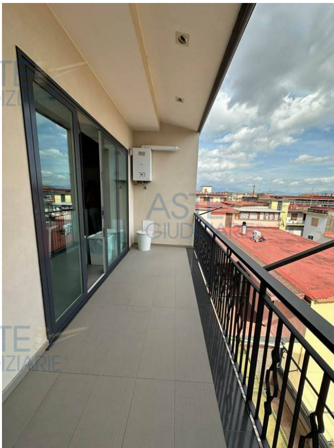
Foto 38 - Il sub 8 – balcone b3
