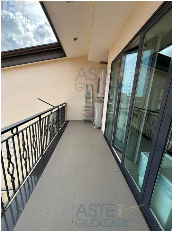
Foto 37 - Il sub 8 – balcone b3
