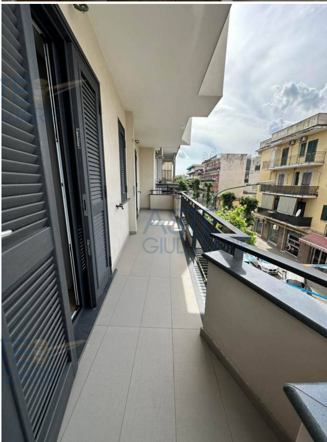
Foto 30 - Il sub 8 – balcone b1
