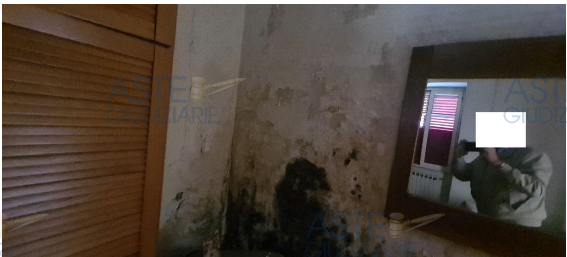
Foto 16 - Macchia infiltrazione da appartamento limitrofo nella Camera 2
