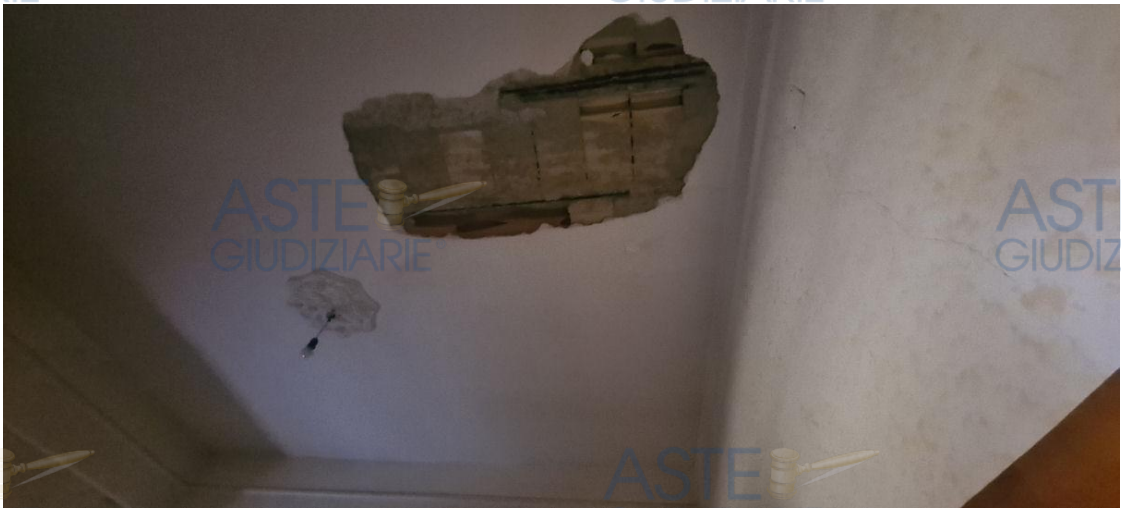
Foto 15 - Distacco dell'intonaco del soffitto nella camera 2
