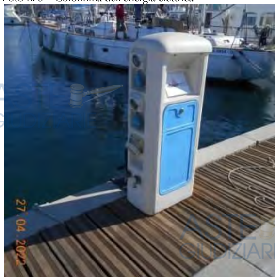
Foto n. 5 – Colonnina dell'energia elettrica
