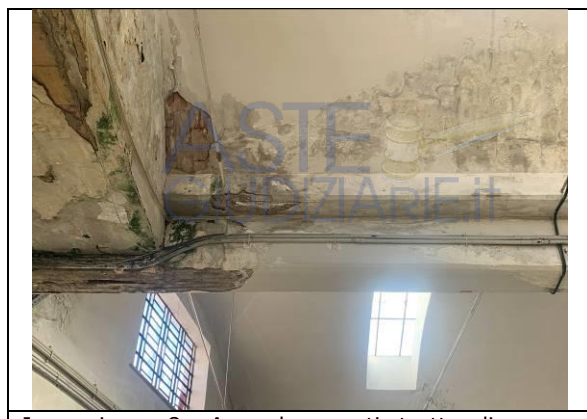
Immagine n. 8 - Ammaloramenti strutturali
