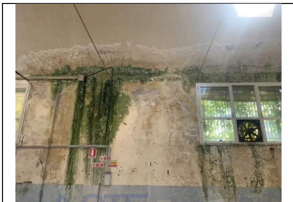
Immagine n. 17 – Dettaglio stato di degrado
