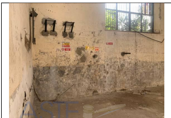
Immagine n. 15 - Dettaglio degrado pareti
