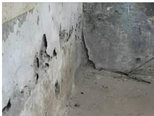
Immagine n. 50 - Dettaglio ammaloramento parete perimetrale
