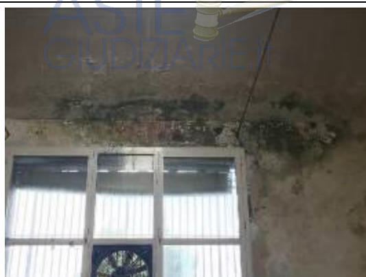
Immagine n. 48 - dettaglio ammaloramento parete perimetrale
