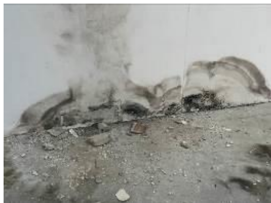
Immagine n. 17 - Dettaglio ammaloramento
