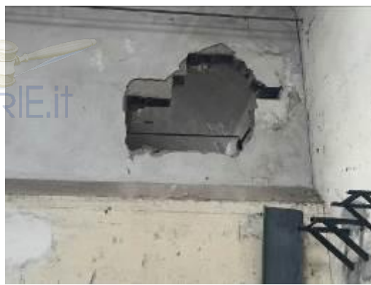
Immagine n. 51 - Foro in parete divisoria ZONA 3
