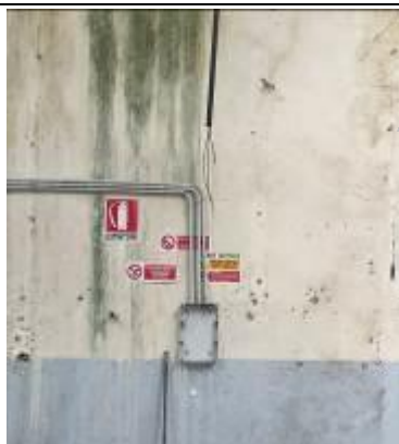
Immagine n.10 - Terminale impianto elettr.
