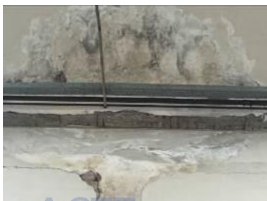
Immagine n. 14 - Stato conservativo trave
