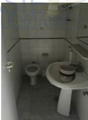
Immagine n. 40 - Bagno uffici
