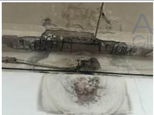
Immagine n. 18 - Dettaglio ammaloramento elementi strutturali
