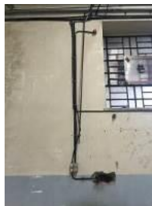
Immagine n. 33 - Dettaglio impianto elettrico
