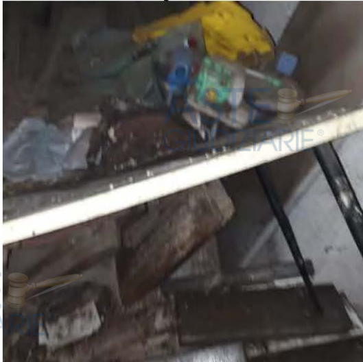
Foto n. 27 – Materiale depositato nel sottotetto sub. 138
